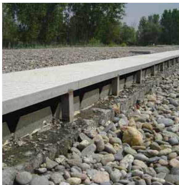
Figura 5.4.6. Empleo de vertederos para el reparto del agua a tratar
