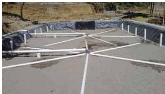
Figura 5.4.11. Humedal artificial de flujo vertical antes de su plantación (Comunidad Venezuela, Comasagua, El Salvador)
