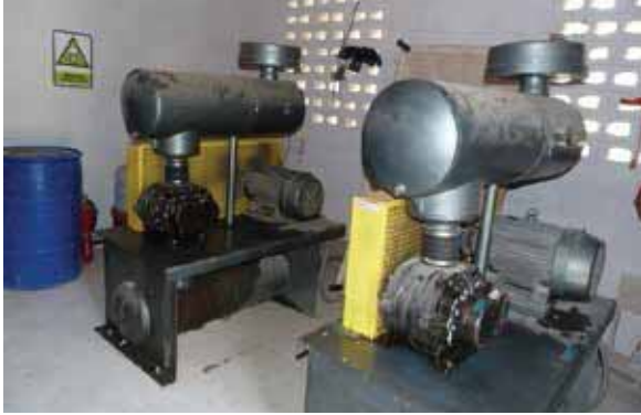
Figura 5.5.5. Sistema de inyección de aire mediante compresores
