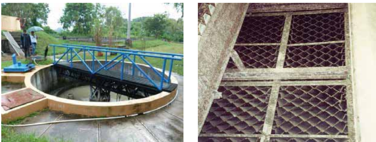
Figura 4.12. a) Sedimentador primario estático (San Luis Talpa, El Salvador), b) Detalle de un decantador lamelar
