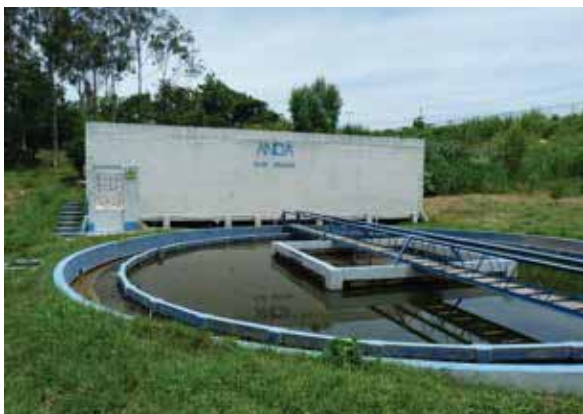
Figura 2.4. Filtro Percolador. PTAR de Apaneca
