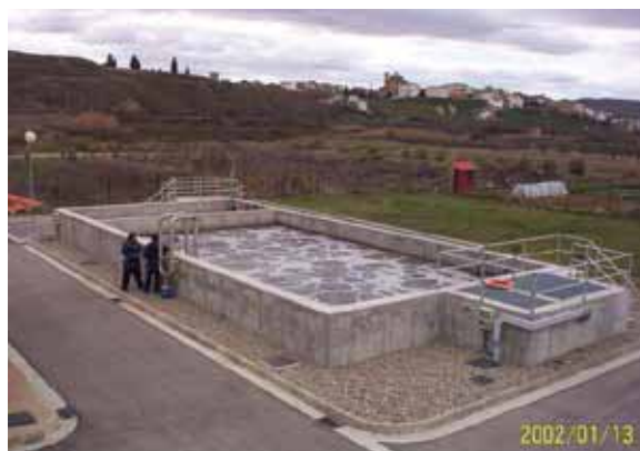
Figura 5.5.2. PTAR de aireación extendida
