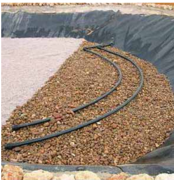
Figura 5.4.5. Tuberías de alimentación apoyadas en la zona de cabecera
