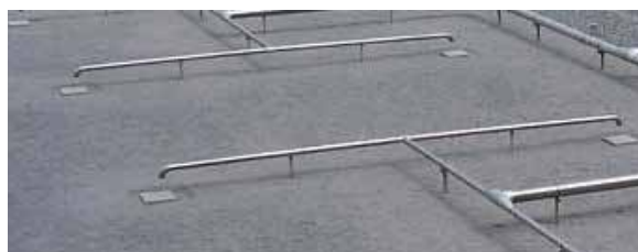
Figura 5.4.10. Tuberías de alimentación apoyadas en pivotes (Fuente: Epur Nature)
