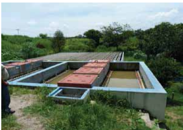
Figura 5.2.5. RAFA seguido de Filtros Percoladores PTAR Ciudad Futura (El Salvador)
