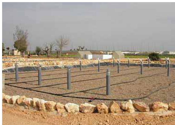
Figura 5.4.9. Tuberías de alimentación apoyadas sobre el lecho
