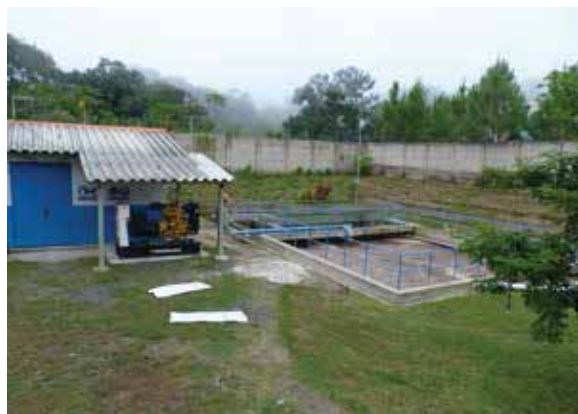
Figura 2.5. Tratamiento de aireación extendida. PTAR Quintas Doradas
