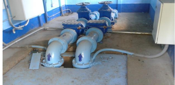
Foto 6. Equipos de bombeo en EBAR Bosco Monje
