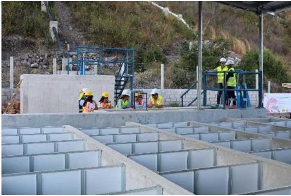
Fotografía 1: Vista de los floculadores de la Planta Potabilizadora ETAP Cabeza de Danto (2018).
