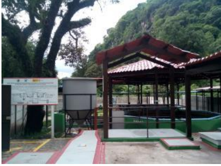
Fotografía 1: Planta de Tratamiento de Aguas Residuales de Tipo Reactores Secuenciales SBR, Barrio 2, San Marcos La Laguna, Sololá
