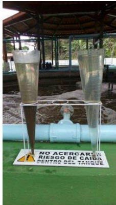
Fotografía 3: Monitoreo a proceso de depuración, Planta de Tratamiento de Aguas Residuales de Tipo Reactores Secuenciales SBR, Barrio 2, San Marcos La Laguna, Sololá.
