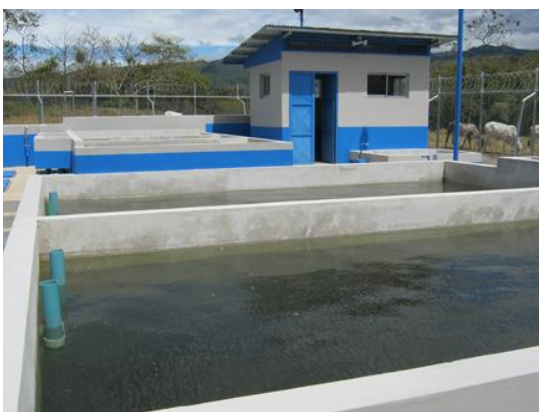
Fotografía 3: Tanques de sedimentación, planta de tratamiento. Acueducto Romakri
