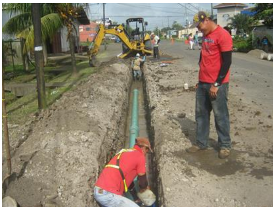
Fotografía 5: Línea de distribución desde acueducto municipal de Upala al asentamiento La Palmera, 9 de agosto 2013
