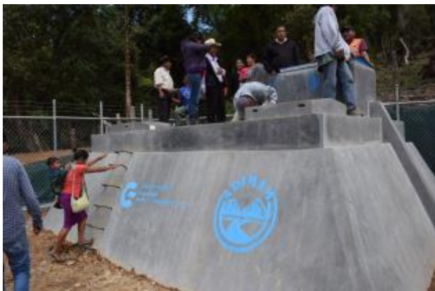
Fotografía 2: Recepción de sistema de Agua y Saneamiento (Tanque de Distribución) en Caserío Santa Bárbara Chiquito, Municipio de Cuilco, Departamento de Huehuetenango.
