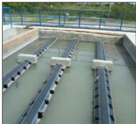
Fotografía 3: Imhoff Mantilla sin deflectores
